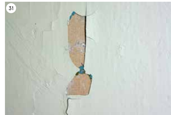
Uunin maalikerroksia. Maalipinta hilseilee irti. ark-byroo, AV.
