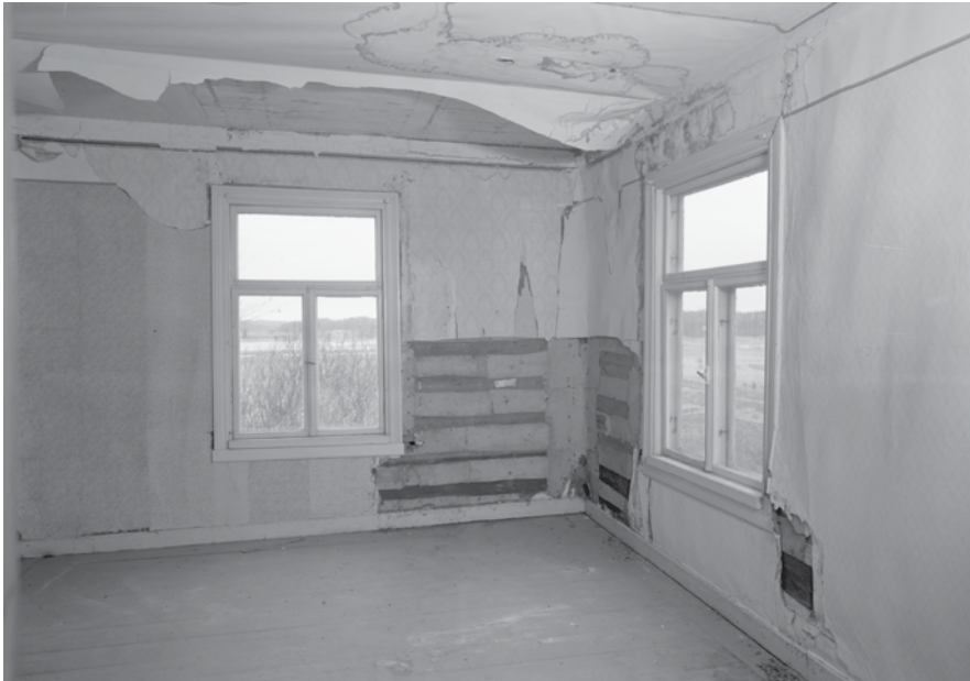
Pintoja avattu, kosteusvaurioita 1978. Kuvaaja P. O. Welin MVHK.
