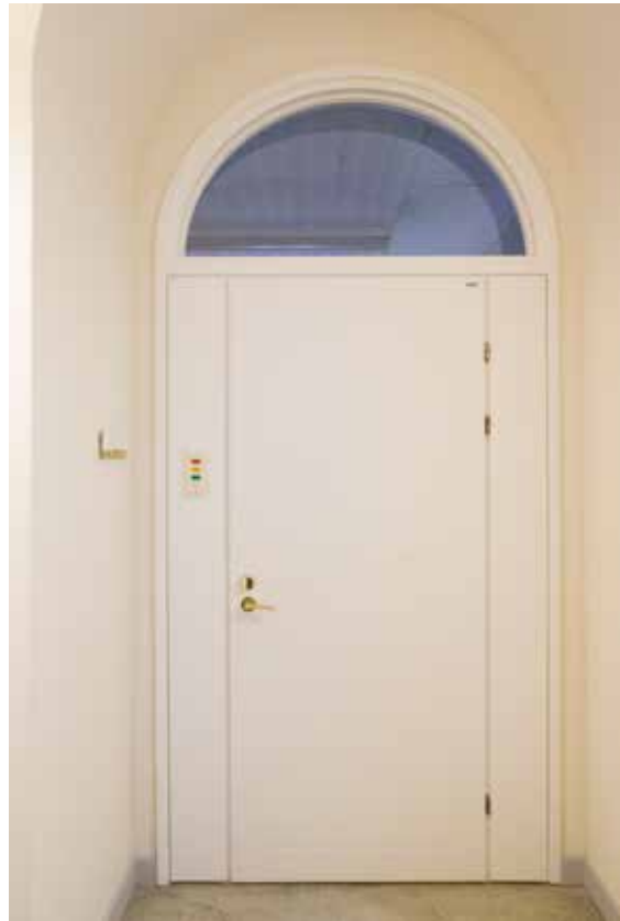
Toimistohuoneen ovi rakennuksessa A. Ovet ovat kaikki uusia.
