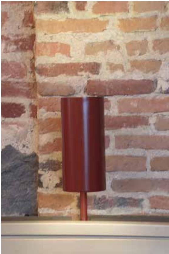
Rakennuksen A kellarikerroksen seinäpaneeliin kiinnitetty valaisintyyppi.
