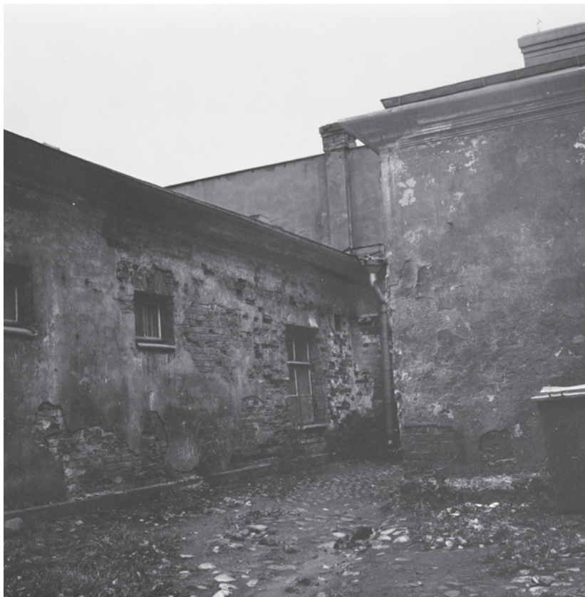
Läntinen keittiösiipi oli pohjoisenpuoleisilta matalilta osiltaan hyvin huonossa kunnossa. Tiloihin oli rakennettu sellejä. Piha oli katettu mukulakiveyksellä. Kuvattu vuonna 1973. Jarkko Sinisalo, MV.
