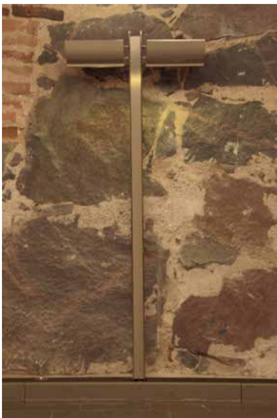
Rakennuksen A kellarikerroksen seinäpaneeliin kiinnitetty toinen valaisintyyppi.
