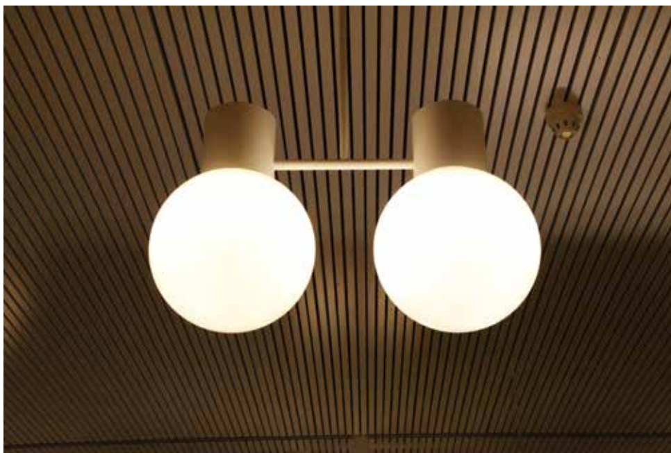
Rakennuksen B kellarikerroksen entisen kirjastotilan kattovalaisin.
