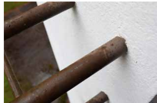
Osa länsipään parvekkeen kaiteesta on teräsbetonia. Keskiosassa rakenteena on avonainen putkikaide, kuten myös itäpään kaidarakenteena.
