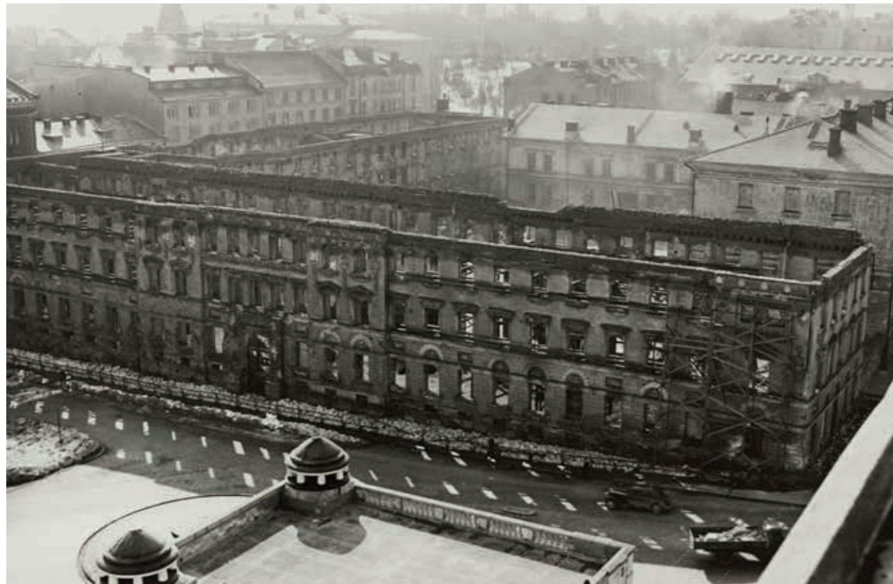
↑ Kaartin kasarmit rauniaina vuonna 1951. Rakenteita oli tuettu vetotangoin ja rakennuksen ulkopuolella kulki suoja-aita, jotta ohikulkijat eivät saisi irtoavia tiiliä kalloonsa. MV
