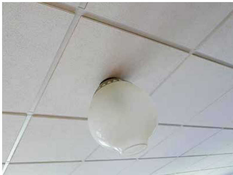
15) Ruokasalin katossa on alkuperäinen, todennäköisesti Paavo Tynellin suunnittelema valaisin.
