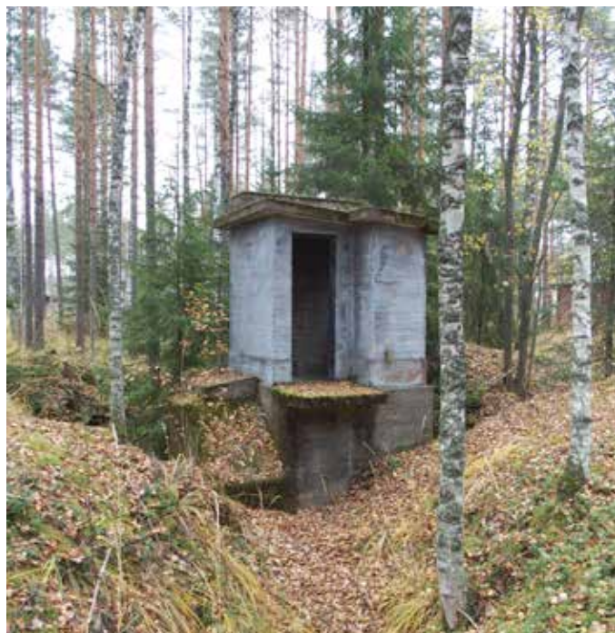
Polttoainepumppaamo kasarmialueen länsiosassa.
