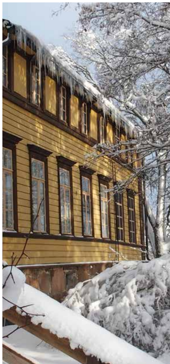
9. Etelän puoleista julkisivua. Rakennuksella on lämpövuotoja, mikä aiheuttaa jääpuikkojen muodostumisen räystäälle.
