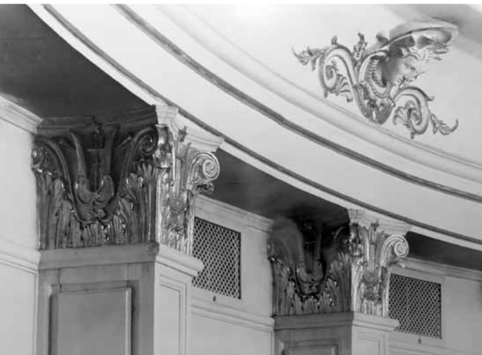
Vuonna 1927 katsomon toisen parven sivuseiniin asennetut ilmalämmitysjärjestelmän säleiköt. Ne on uusittu 1980-luvun vaihteen peruskorjauksessa. Hakli/SKO
