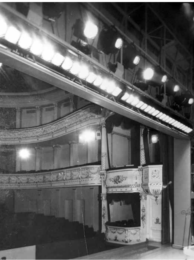
Näyttämön vuonna 1958 uusittuja valaistuslaitteita kuvattuna pian töiden valmistumisen jälkeen. Tuomi/SKO
