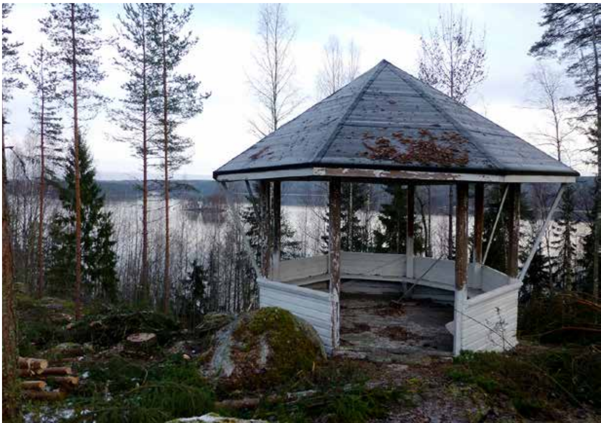
Johtolan huvimaja on päässyt huonoon kuntoon. Huvimajalta alkavat jyrkät portaat Paratiisirantaan.
