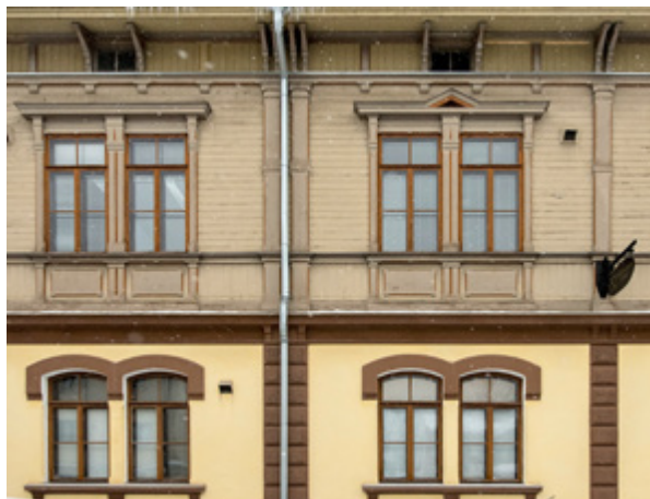
Raitisilmaventtiilejä rakennuksen länsisivulla.
