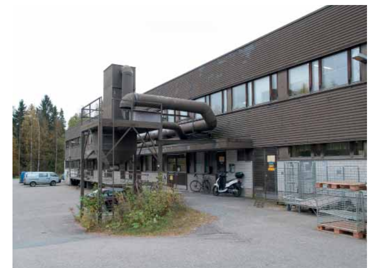
Itäisivulla oleva purunkeräyslaitteisto.
