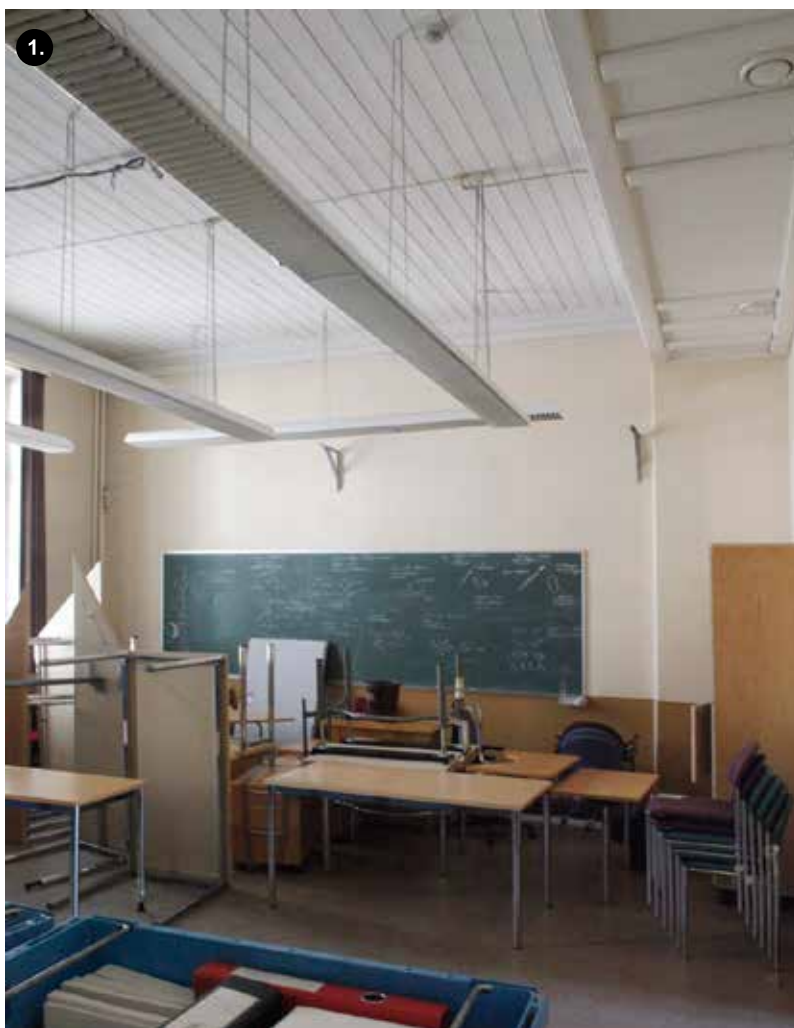
Ilmastointikanavat kulkevat luokkahuoneen alaslasketussa katon osassa.
