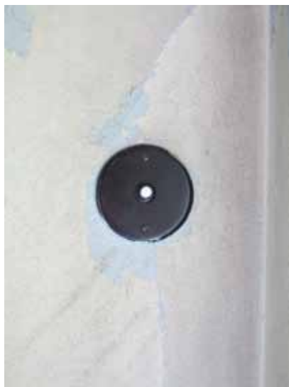
Painonappi D-portaan ala-aulassa.
