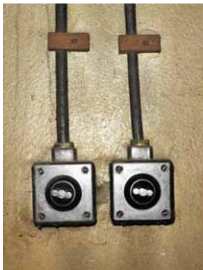
Valumetallisia järeitä kytkimiä 1. kerroksen autohallissa. Tammesta tehdyt kaapelikiinnikkeet ovat tyypillinen teollisuusrakentamisen ratkaisu jo sotaa edeltävältä ajalta.
