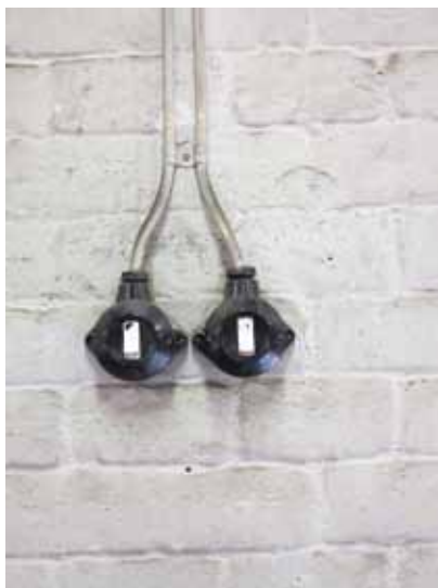
Hieman nuorempia, tiettävästi 1960-l, kytkimiä 3. kerroksen autohallissa.
