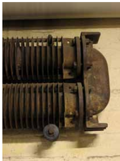
Autosuojaissa, kuten tässä 1. kerroksessa, on käytetty järeitä ripaputkiradiaattoreita, joko yksittäisinä tai yhteenliitettynä.
