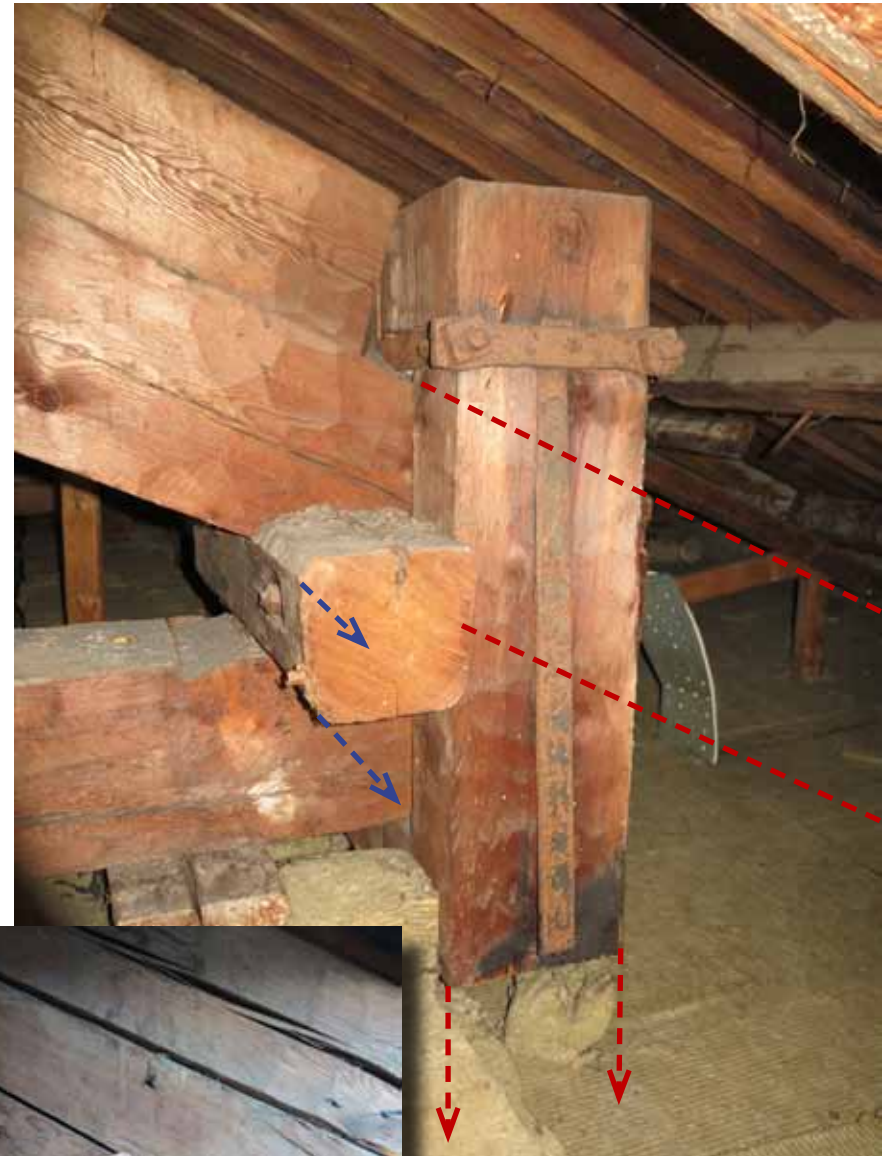
Kattorakenteen liitoskohta DET 1. (kts. edellinen sivu), nykyisessä muodossaan. Lappeen suuntaiset palkit (kaksi päällekkäin) on katkaistu pystypuun linjassa. Rautasiteen tehtävänä on ollut vastaanottaa vetovoima, joka kohdistui pystykappaleeseen. Pitkittäisuuntainen ohuempi sidepuu (sinisellä) on niin ikään katkaistu 1950.
