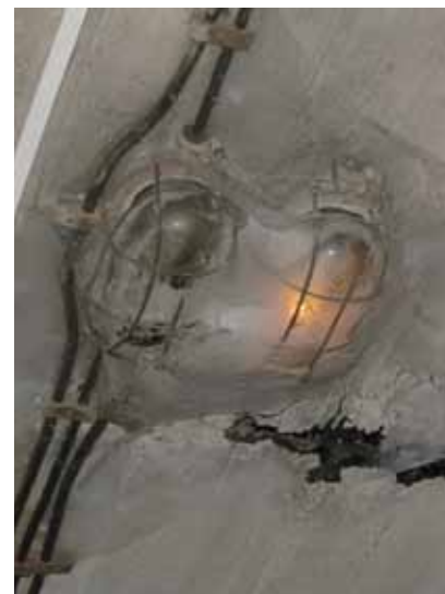
Vuoden 1950 autosuojien kattovalaisimia on säilynyt paikoin, kuten 1. kerroksessa, jossa hämähäkit ovat havainneet valolähteen oivaksi saalistusympäristöksi. Huomaa kaapelointitapa ja tamminen kiinnike.
