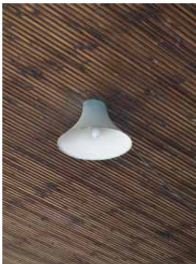
Kattovalaisin huoltoaseman lipassa
