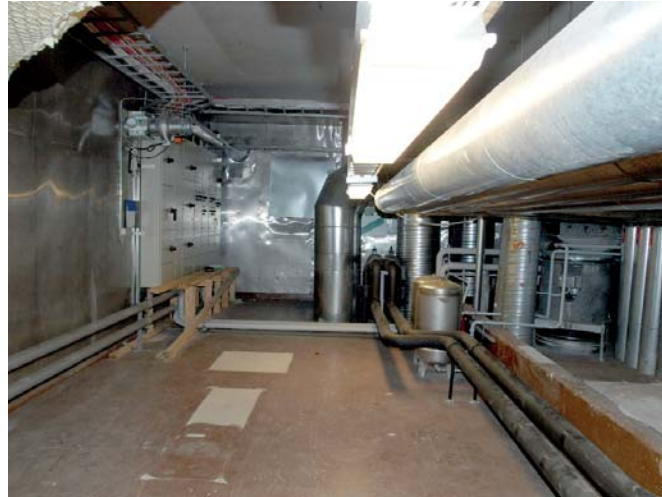
Alkuperäistä IV-konehuonetta. Osa laitteistosta / kanavistosta on siirretty uusiin konehuoneisiin.
