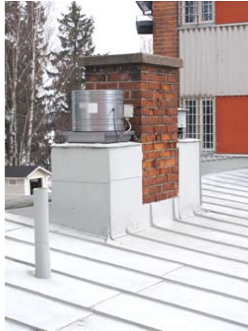
Yllä matalan nivelosan koneellisen poiston huippumuri (uusi, sinkki-pintainen) ja entisen saunan piippu.
