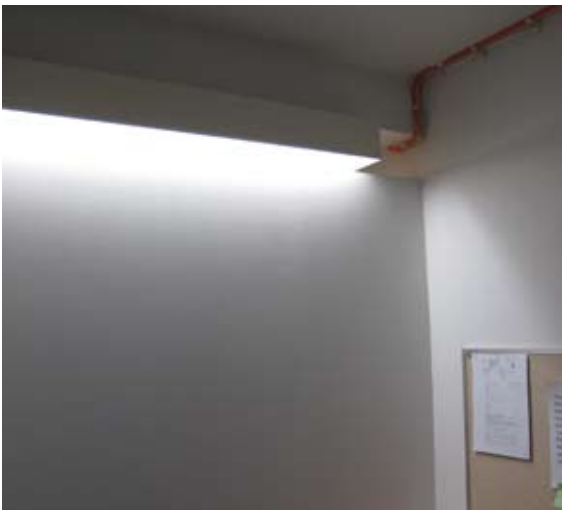
Tornien osastovartijahuoneen väliseinän ja katon väliseen rakoon sijoitettu valaisin.
