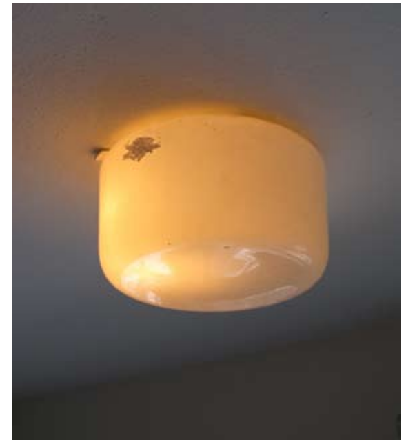
Vanhemman mallinen lasinen yleisvalaisin tornien porrshuoneessa.
