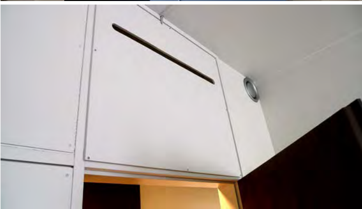
↑ Työhuoneen ovipaketin "tuloilmaelimen" rako käytävän suuntaan (yllä) ja työhuoneen suuntaan (alla). am oy 2010.
