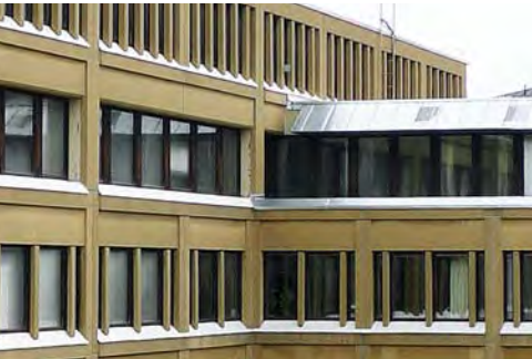
↑ Viidennen kerroksen räystääspellityksen uusimisen jälkeen (Pel- tipojat Oy, 2009) pellitysten alareunat eivät enää kohtaa. Uusitun räystääspellin jatkoksissa reunat on kiinnitetty päällekkäin limisaumalla kansiruuvein (kts. alla). am oy 2010. am oy 2010.
