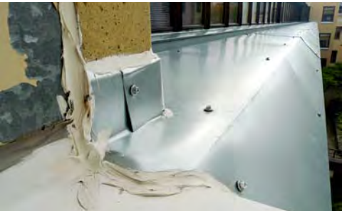
↑ Yllämainittu viidennen kerroksen uuden räystääspellityksen ja vanhan ikkunapellityksen liitos vuodelta 2010.
