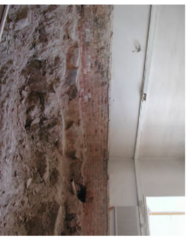
Entisen pesu-ja leivintuvun (huone 114, ensimmäisen kerroksen eteläinen pää) eteläisessä ulkoseinässä havaittiin varsin runsaasti kosteutta. Kosteuden lähteeksi osoittautui lopulta vanha viemärin pää, josta ohjautui vettä lounaispäädyn alapuolisiin rakenteisiin.
