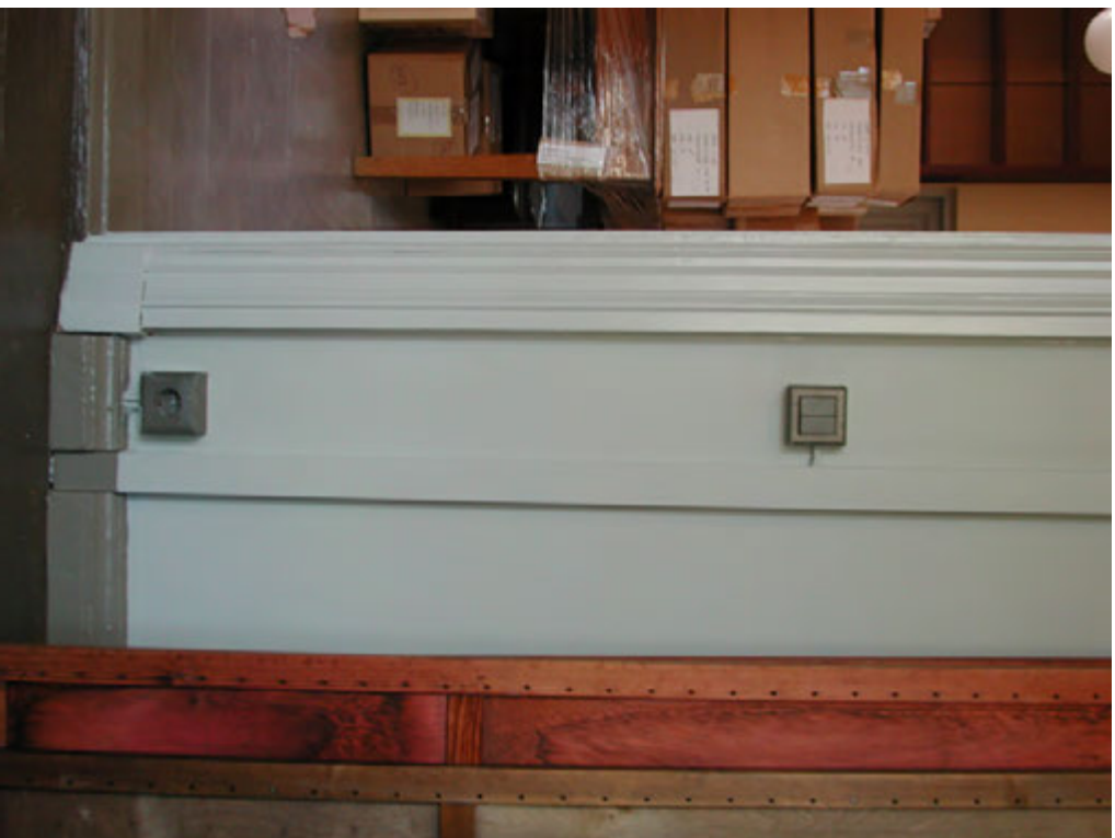
Sähköjen pinta-asennus osoittautui muuntelukelpoiseksi ja esteettisestikin tyydyttäväksi ratkaisuksi. Seinien väriin maalatut pinta-asennuskotelot eivät ole kokonaisuudessa silmäänpiistäviä.
