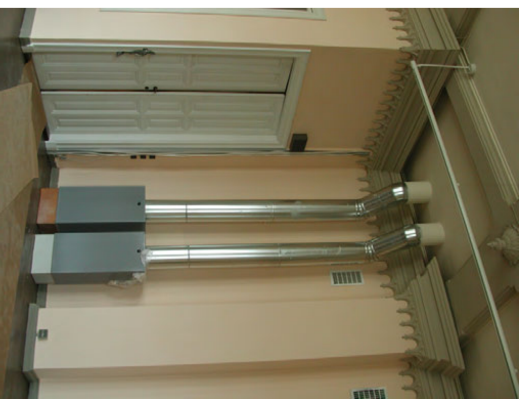
Ilmanvaihdon perusratkaisu huoneessa 307, ennen viimeistä pintakäsittelykierrosta. Tuloilma on tuotu syrjäyttävän periaatteen mukaisesti matalalla virtausnopeudella huoneilassa suhteellisen alas ja poisto tapahtuu vanhoja hormmeja myöten huoneen yläosasta.
