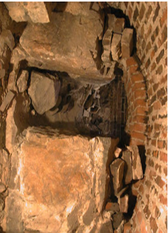
Alla: Kellaritila huoneen 120 alapuolella; osa perusmuurin lohkaresta oli huomattavan suurta, jopa lähes metrin mittaisia
