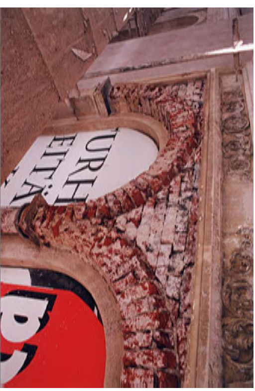
Yllä: Kesän 1999 aikana pudotettiin rappaukset suurelta osalta katu-julkisivuja. Aiheesta lisää liitteessä 2.
