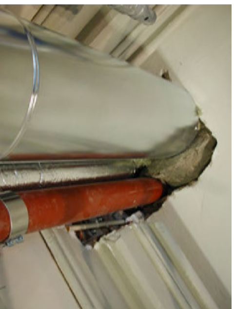
IV- ja putki läpiviennit huoneessa 303
