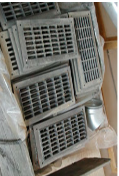
Ullakolla, ilmanvaihtokonehuoneen tilassa hormoneja on avattu kyljistä ja putken päät pilkistävät.
