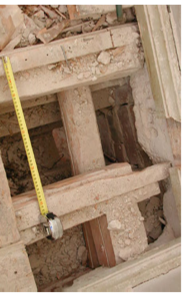
Huoneen 404 lounaisnurkan lattia-avaus; nurkassa kehyslautojen tuenta sekoittaa palkkijakoa
