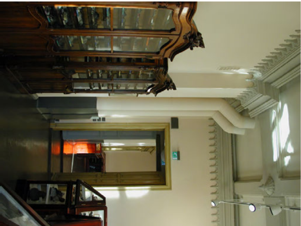
Salin 308 harmaiden tuloilmaelinten putket ovat pääosin seinän väriset, osittain katon väriset.
