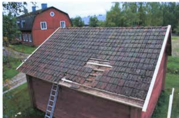
Aittarakennuksen katossa oli muutamia vuotokohtia
