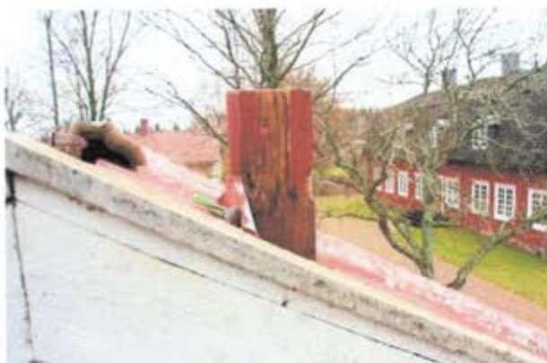
Juuripellit irrotettuna ja lahoa pystyparrua
