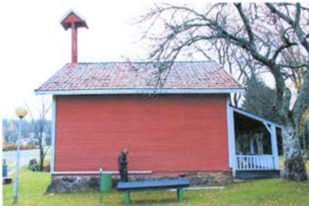
Tämän seinustan oikeassa alanurkassa oli lahovaurio
