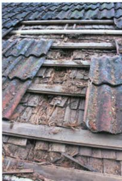
Aitan katon vuotokohta, ennen aluskatteen korjaamista
