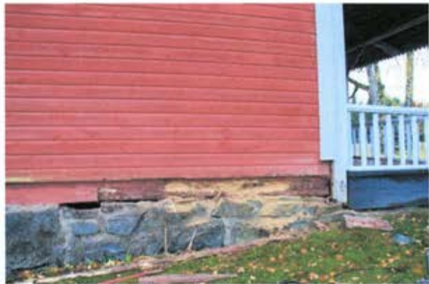
Lahovaurio on syntynyt tippalistan uitettua vettä seinään päin
