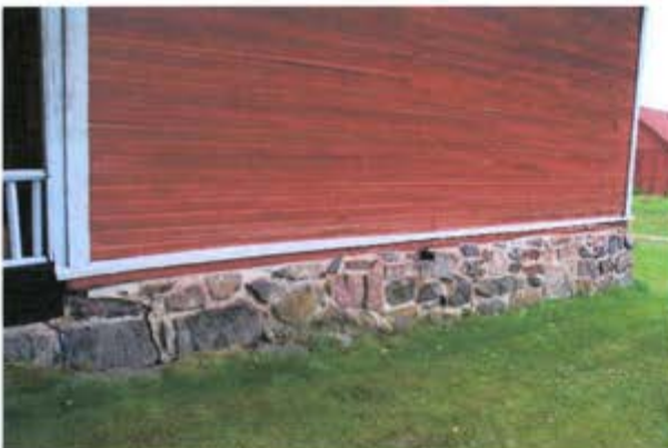
Vanha tippalista kallistui paikoin seinään päin
