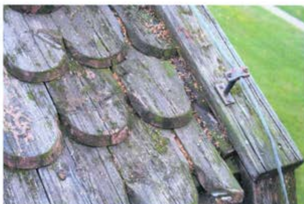
Tuulilaudan alla olevat paanut ovat täysin lahonneet
